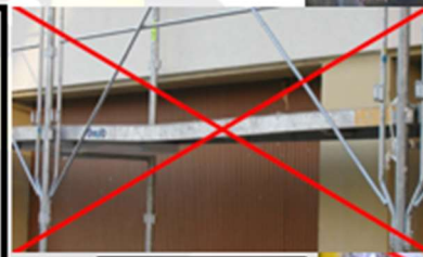
Le cadre du plancher est déformé.
