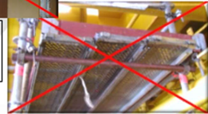
Les planchers ne sont pas fixés.
